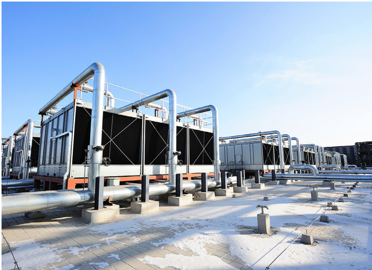
Figure 24 : Tours aéroréfrigérantes ( cooling towers )
